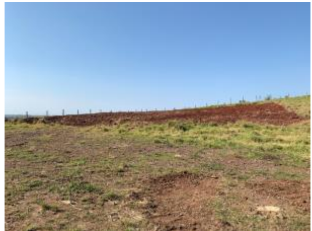
Baia de contenção desmobilizada.
