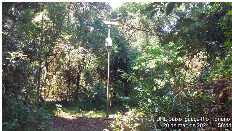
Figura 41 – Estação Telemétrica UHE Baixo Iguaçu Rio Floriano
