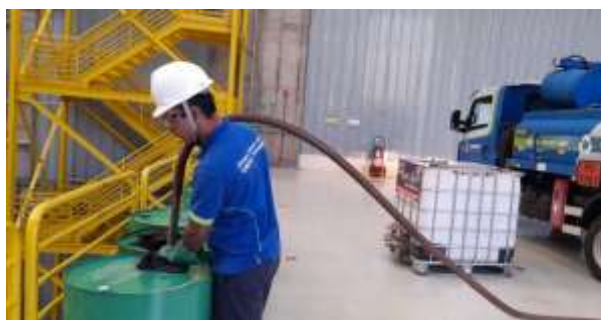
Coleta de óleo contaminado casa de força
