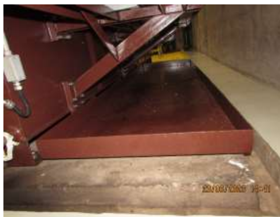
Contenção de óleo unidade hidráulica sem presença de óleo
