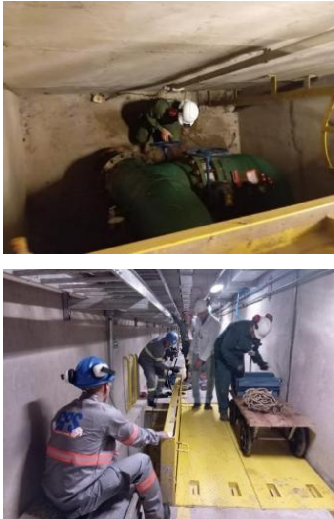
Figura 4..16.2-7. Abertura da válvula de esgotamento caixa espiral
