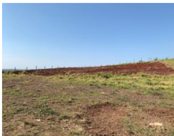
Baia de contenção desmobilizada.
