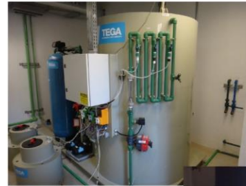
Estação compacta de tratamento de água UHE Baixo Iguaçu
